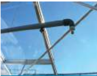
Rampe de brumisation
