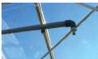
Rampe de brumisation
