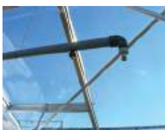
Rampe de brumisation
