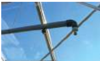
Rampe de brumisation
