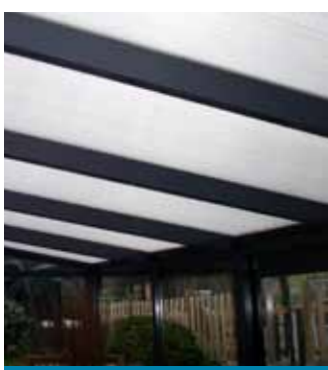
Toiture en polycarbonate
