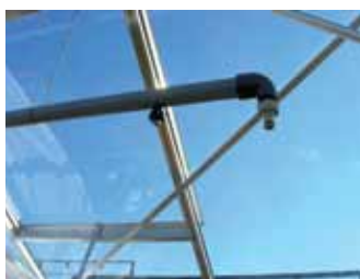
Rampe de brumisation
