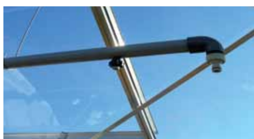
Rampe de brumisation
