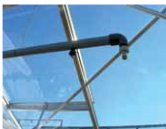
Rampe de brumisation
