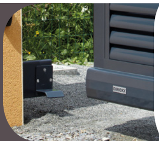
Absence de rail au sol
