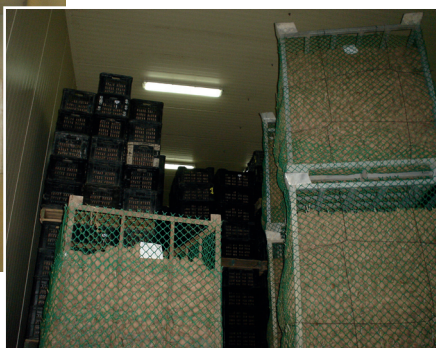
Chambre froide positive de grande capacité 400 tonnes
