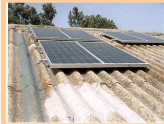
Photo 1: Les cellules photovoltaïques sur le toit
