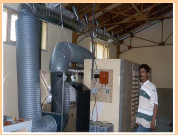
Photo 2: Le chauffage complémentaire
