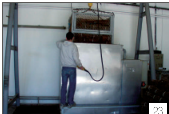
Appareil de traitement à l'eau chaude en fonctionnement (cliché ENTAV)
