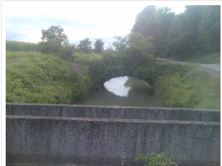
La végétalisation des parois de ce pont augmente son potentiel d'utilisation comme corridor
