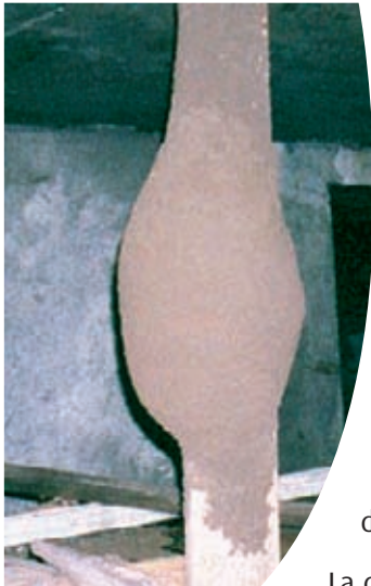
« Nid » érigé de termites souterrains de l'espèce Coptotermes gestroi
