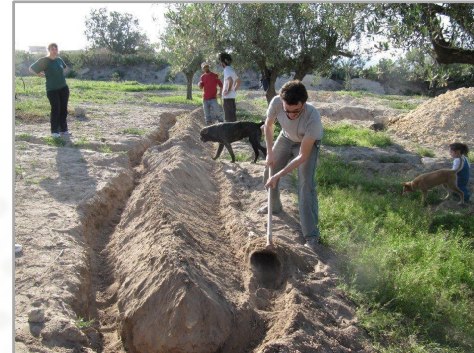
A Hajeb-El-Ayoun, atelier construction de baissière (ou swale) pour la récupération de l'eau de pluie
