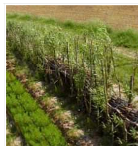
Au printemps , une toute jeune haie reconstruite de saules et incorporant des fascines en fagots, ceci pour stabiliser des terrains soumis au ruissellement dans le Pas-de-Calais, France.
