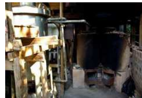
Les chaudières sont isolées thermiquement mais continuent à fonctionner au bois
